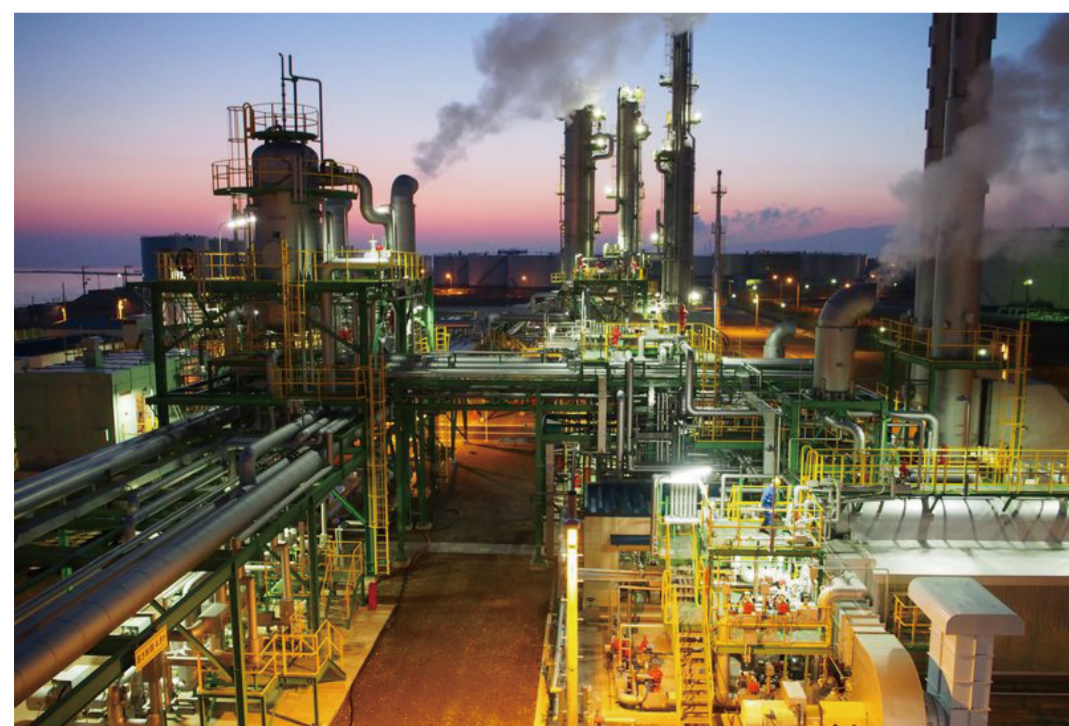
北海道苫小牧市のCCS実証実験プラント 出典：経済産業省資源エネルギー庁 エネこれ 2020-11-27 より
