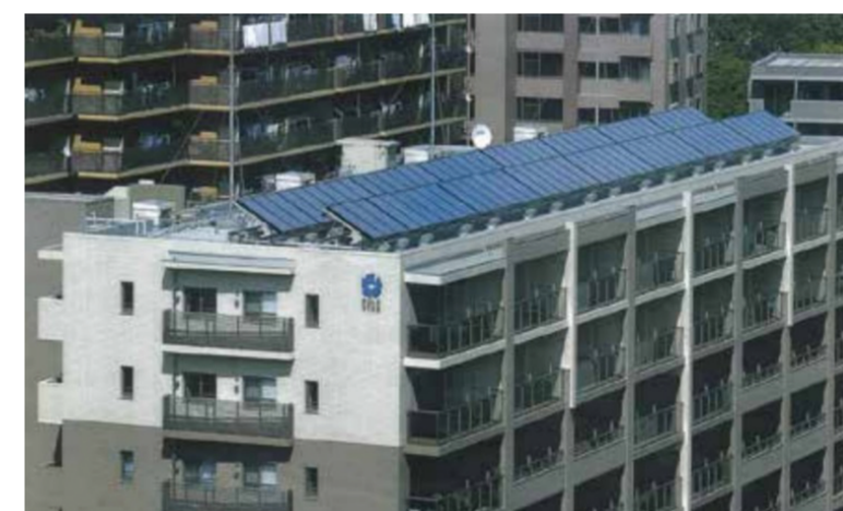
マンション屋上の太陽熱利用(東京都東大和市)
