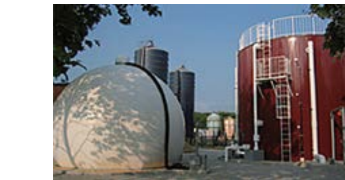
酪農における牛の排せつ物を発酵させて得られるバイオガスを発電に利用。出力37kW
