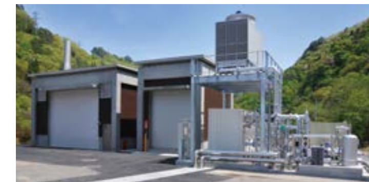
森林から得られた木材パレットなどを燃焼させて発電し、特産のきのこ栽培に電気を供給している。出力180kW
