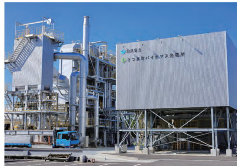
バイオマス発電所 (鹿児島県さつま町)
